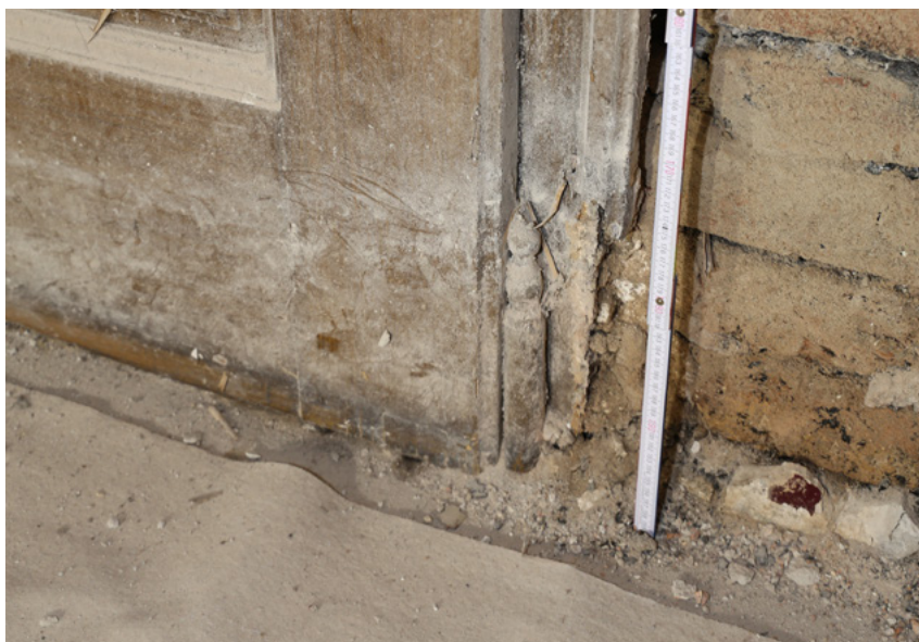
Slika 29. Loše stanje dovratnika s unutrašnje strane zida zbog truleži i nepravilnog izlijevanja betonske ploče do previsoke kote.
