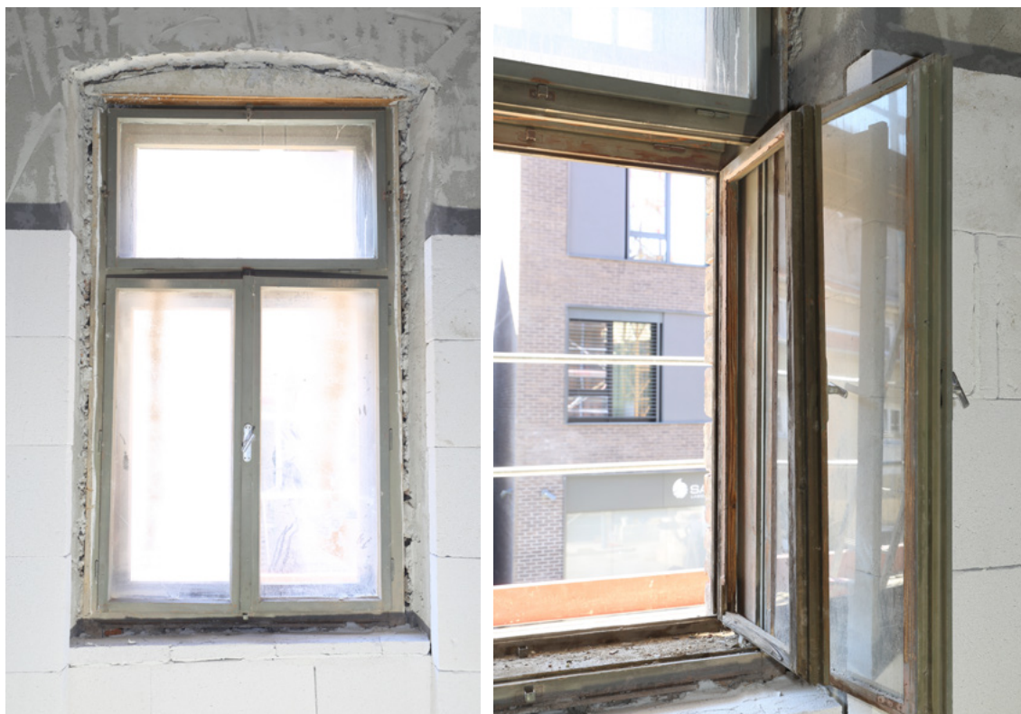
Slika 9. Pogled s unutarnje strane na prozor s nadsvijetlom odaje dojam funkcionalnog proizvoda. Kakogod, u otvorenom stanju se vidi značajna deformacija vitoperosti vanjskoga krila. Osim očitih deformacija koje onemogućuju normalno korištenje prozora, ovo je i primjer neodgovarajuće replike ugrađene tijekom ranije obnove zgrade.
