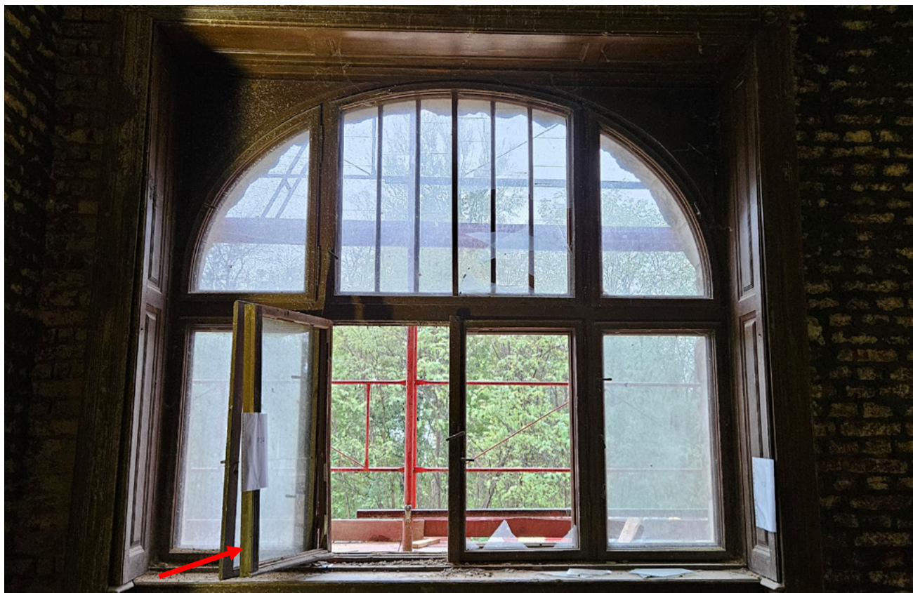
Slika 17. Tipičan primjer dvostrukog prozora sa spojenim krilima (tzv. krilo na krilo). Donja krila su zaokretna, gornja se otvaraju za potrebe čišćenja. Zamijeti deformaciju i odvajanje unutarnjeg krila od sklopa.
