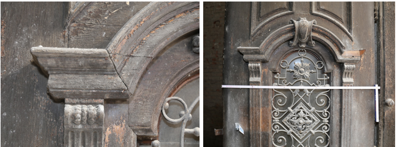
Slika 27. Uredno izveden kutni spoj vertikalnih, horizontalnih i zaobljenih elemenata s vanjske strane krila. Detalj desno pokazuje da su opšavi spajani i po debljini zbog lakše izvedbe i uštede materijala, a kutno su spajani „na gerung“ (tupim kutnim sučeljem pod 45°) radi izbjegavanja izloženosti čelnog presjeka drva.
