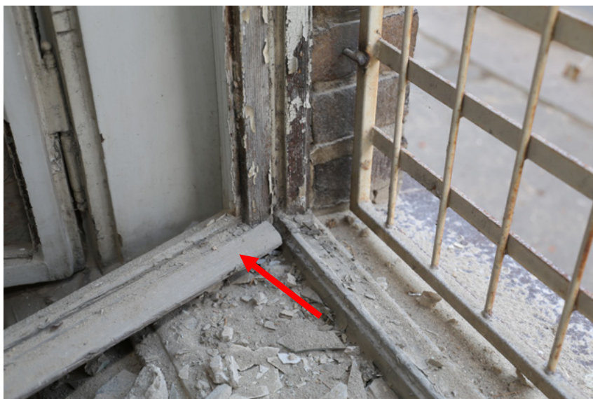
Slika 12. Prikaz potpunog oštećenja i ljuštenja sloja površinskog premaza u donjem lijevom kutu vanjskog doprozornika i krila (crvena strelica). Vanjski dio špalete obložen je fasadnom opekom. Čelična rešetka ne pripada u stilsko razdoblje.
