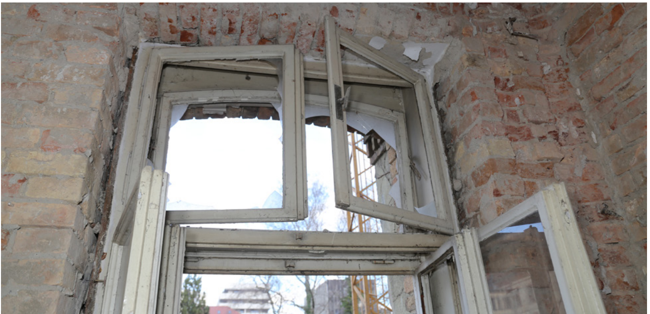
Slika 11. Pogled iznutra na tipičan prozor na zgradi. Vanjsko krilo nadsvjetla se otvara otklopno, a sva ostala krila zaokretno, središnjom kvakom i kliznim šipkama. Posluživanje krila nadsvjetla zahtijeva uspon na klupčicu ili ljestve; otklopno krilno nadsvjetla sa središnjom rezicom se može otvoriti i motkom s kukom, no izvjesno se otvaralo rijetko, uglavnom za potrebe čišćenja.
