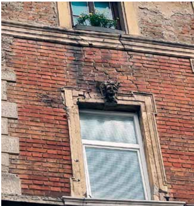
6 Rijeka, pukotine i deformacija zida na zapadnom pročelju palače Bakarčić (foto: A. Radelić, 2020.)
