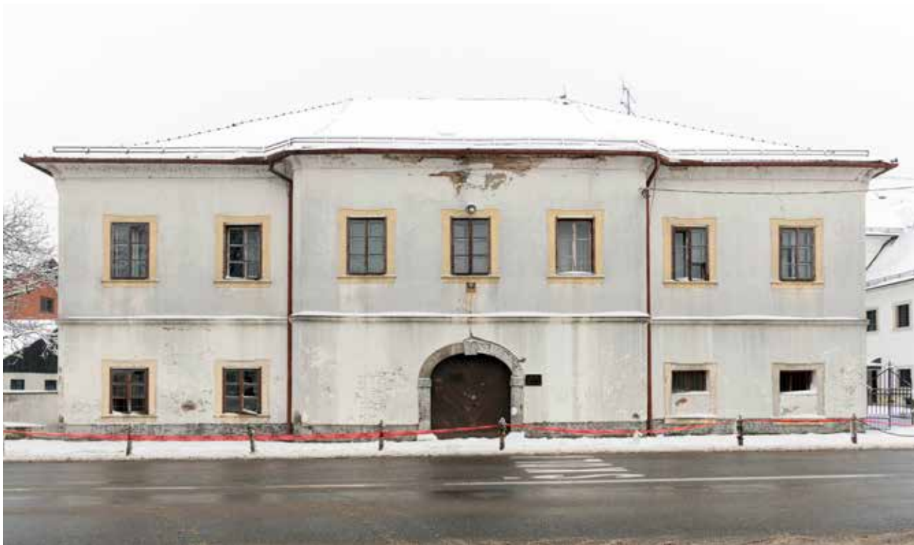
12 Župni dvor u Selima, vanjšina - stanje nakon potresa (foto: G. Tomljenović, fototeka HRZ, 2021.)
