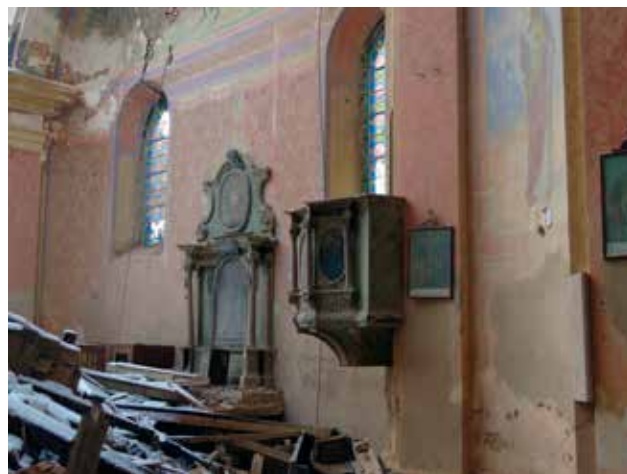
6 Crkva sv. Nikole i Vida u Žažini, bočni oltar Majke Božje Žalosne oštećen uslijed urušavanja svoda (foto: T. Horvatić, MKM, 2021.)
