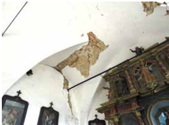
Lenišće, Kapela sv. Margarete, oštećenja u unutrašnjosti kapele zadobivena u potresima 28. i 29. 12. 2021.
