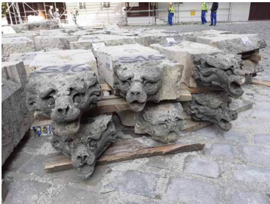
3 Demontirani oštećeni kameni elementi vodoriga sa zvonika katedrale Uznesenja Marijina na Kaptolu (Fototeka, GZZSKP, 2023.)
