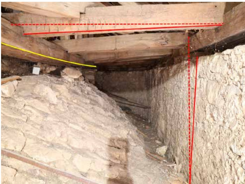
4 Demonstracija posljedica dugoročnih i potresnih pomaka krova (pogled s bočnoga svoda ispod drvene rešetke; kamera je bila nivelirana). Obrubna greda kupole savijena je prema dolje i na van, stoga je rešetka „potonula“ prema kupoli te se izmaknula prema nakošenom zidu (foto H. Turkulin, 2021.)
