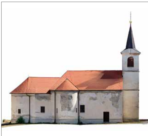
5 Trgovišće, kapela Majke Božje Žalosne, stanje snimljeno prije početka radova konstrukcijske sanacije, jugozapadno pročelje (VEKTRA d.o.o., Varaždin, 2023.)
