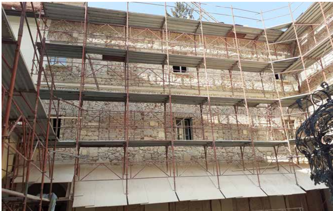
22 Dvorišno pročelje zapadnog krila samostana uz crkvu Uznesenja Blažene Djevice Marije u Remetama, nakon uklanjanja žbuke s vidljivim faznim zatvaranjem trijema na katovima (Fototeka, GZZSKP, 2020.)
