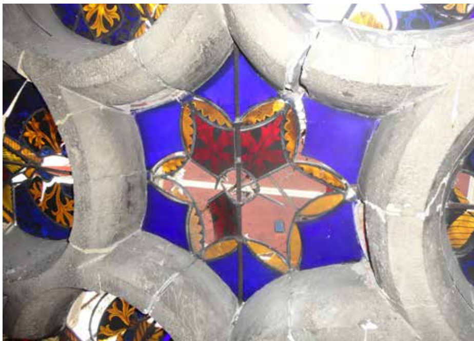
1 Oštećenje vitraja i kamenih elemenata rozete u svetištu katedrale Uznesenja Marijina na Kaptolu (Fototeka, GZZSKP, 2020.)
