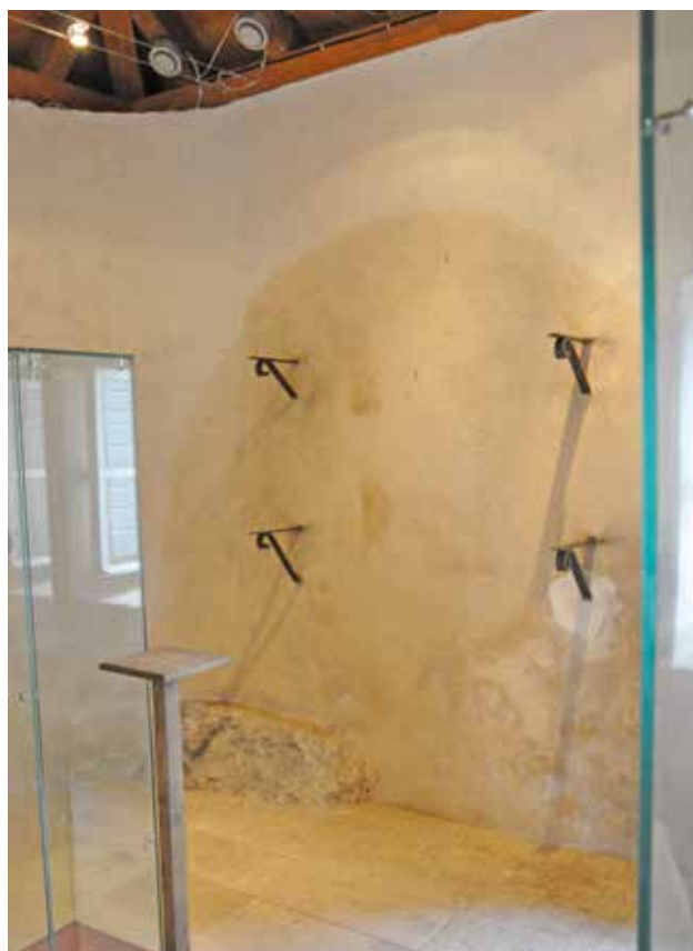
2 Oborinsko vlaženje južnoga zida zgrade (foto: S. M. Sunara, siječanj 2014.)
