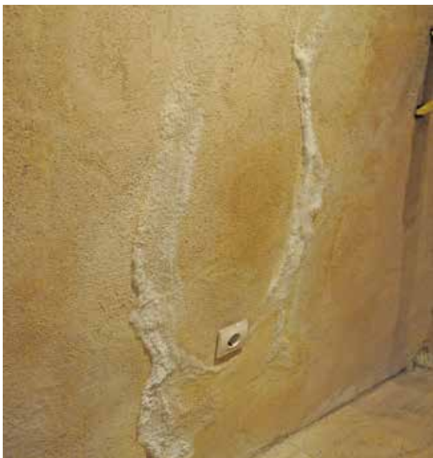
3 Naslage kristala soli na površini žbuke (foto: S. M. Sunara, ožujak 2014.) Efflorescence on the plastered wall (photo: S. M. Sunara, March 2014)
