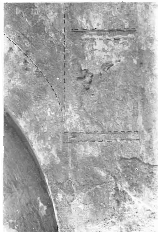
30 Sakristija, zapadno pročelje: detalj spoja luka prigrađenog trijema iz 1727. i pilastra iz 17. st.
