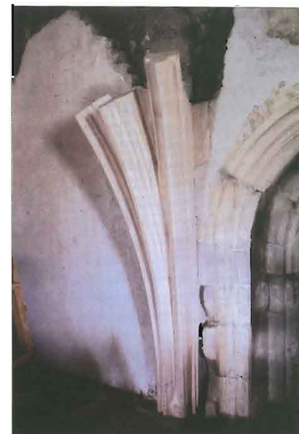
62 Kapela sv. Trojstva, rekonstruirana sjeverna račva svoda u lađi
