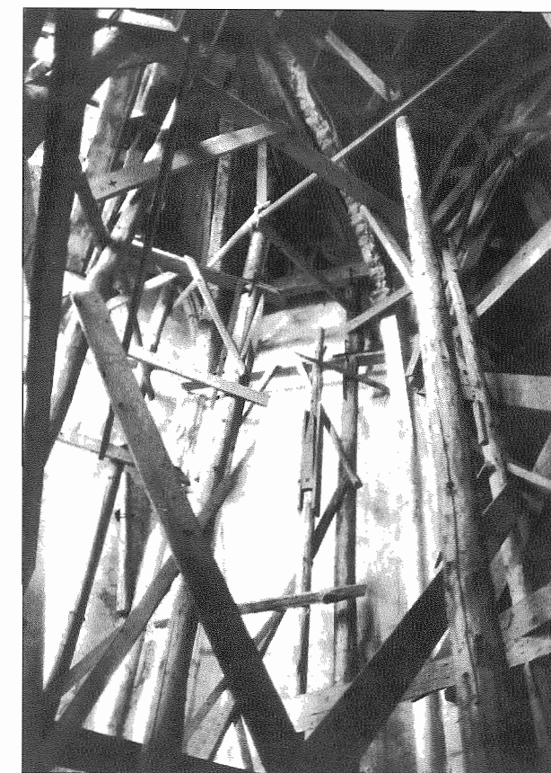
44 Kapela sv. Trojstva, unutrašnjost, podupore u lađi, stanje 1982. Chapel of the Holy Trinity, interior, props in the nave, situation in 1982
