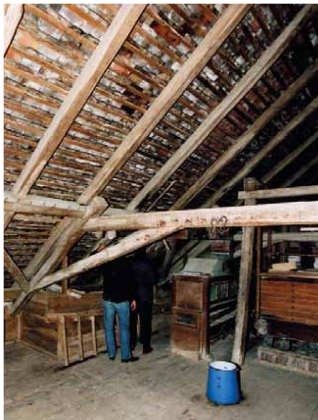
11 Loše stanje krovišta izazvalo je oštećenja daščanog poda, stanje 2006. (foto: Z. Bogdanović)
