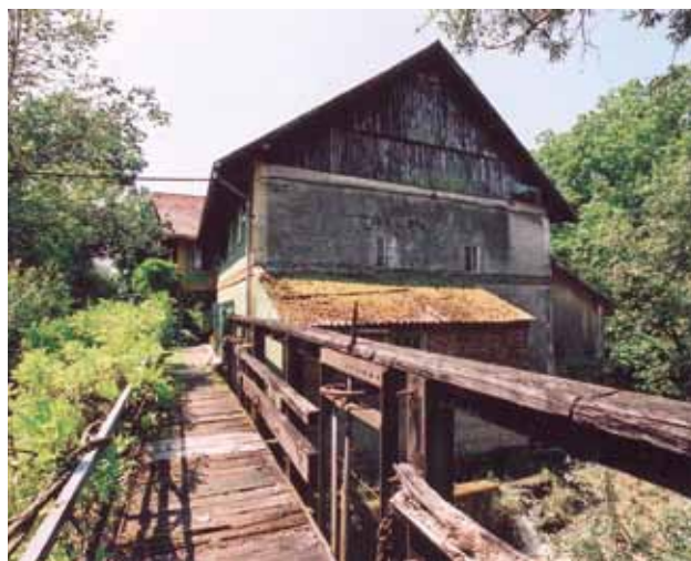
12 Dotrajali most i dijelovi vanjskog postrojenja, stanje 2007. (foto: A. Mlinar)
