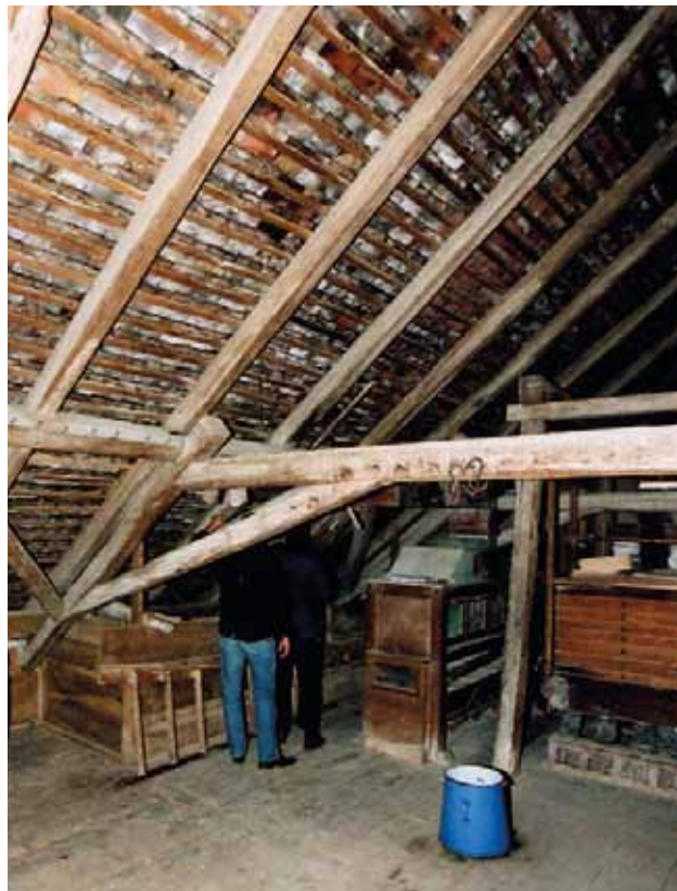
11 Loše stanje krovšta izazvalo je oštećenja dasčanog poda, stanje 2006. (foto: Z. Bogdanović)
